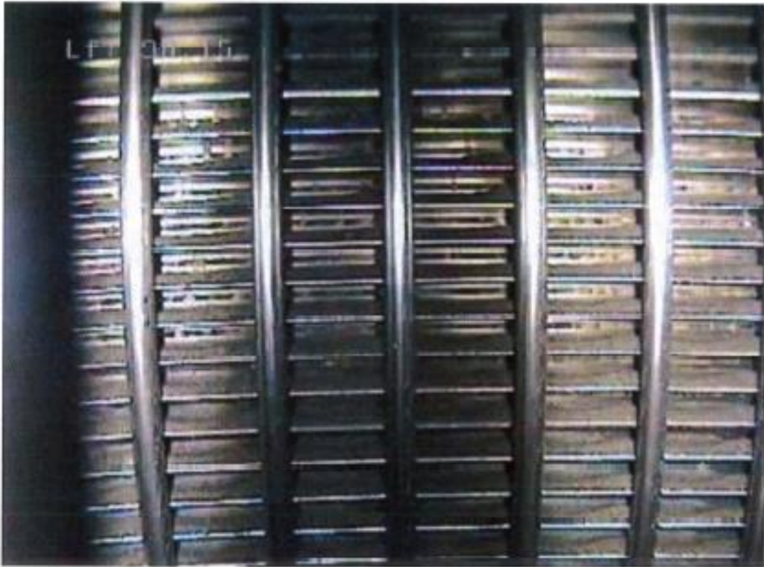
17- Tubage inox crépiné (90.15 m) – léger dépôt de sable fin grisâtre
