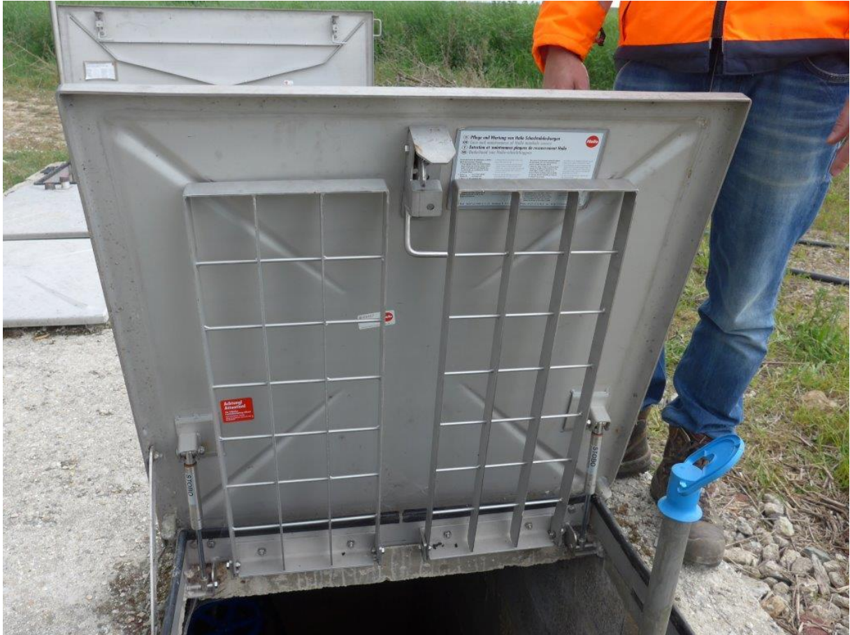
Photo 3 : Trappe du regard
