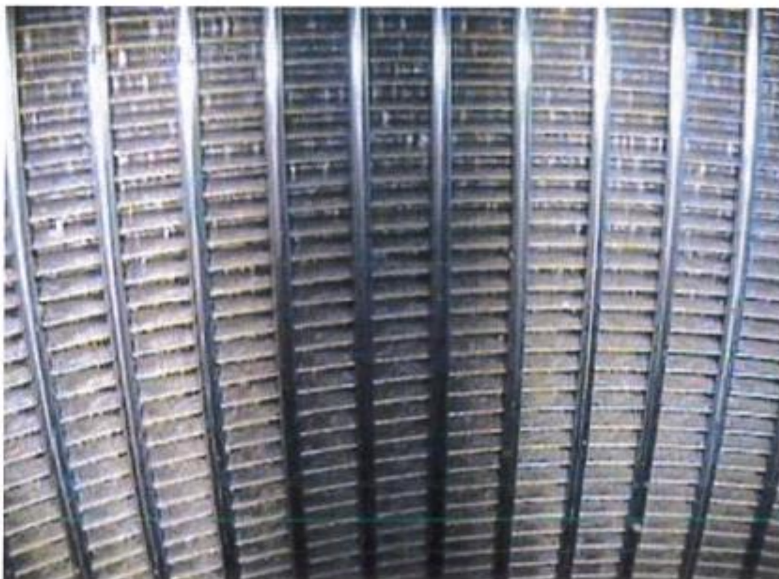
14- Tubage inox crépiné (79.50 m) – léger dépôt de sable fin, massif filtrant visible
