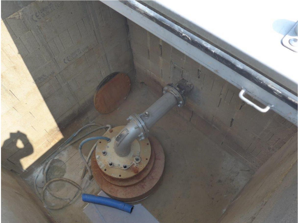
Photo 2 : Tête de puits
